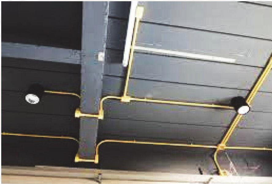
รูปที่ 3.1.11 ตัวอย่างระบบท่อพีวีซีที่ติดตั้งและเดินสายร้อยท่อแล้ว
