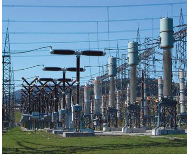
ลานไฟฟ้า
